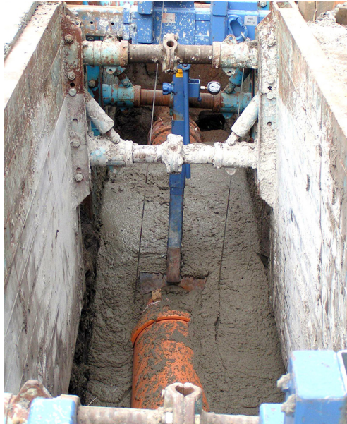
Der Einsatz von Rohrverlegehilfen dient zur Lagesicherung und der Messung des Auftriebes. Foto: LOGIC
